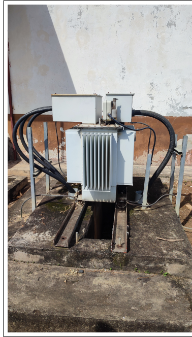
FIGURE 8 – Transformateur pour le renforcement du neutre
