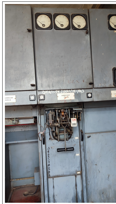
FIGURE 7 – Ancienne installation du poste SNEL
